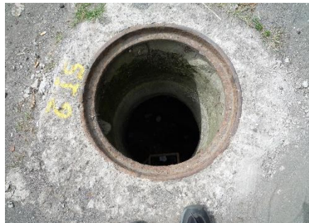
盗まれるマンホールの蓋
