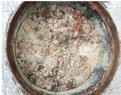
廃油で詰まったマンホール
