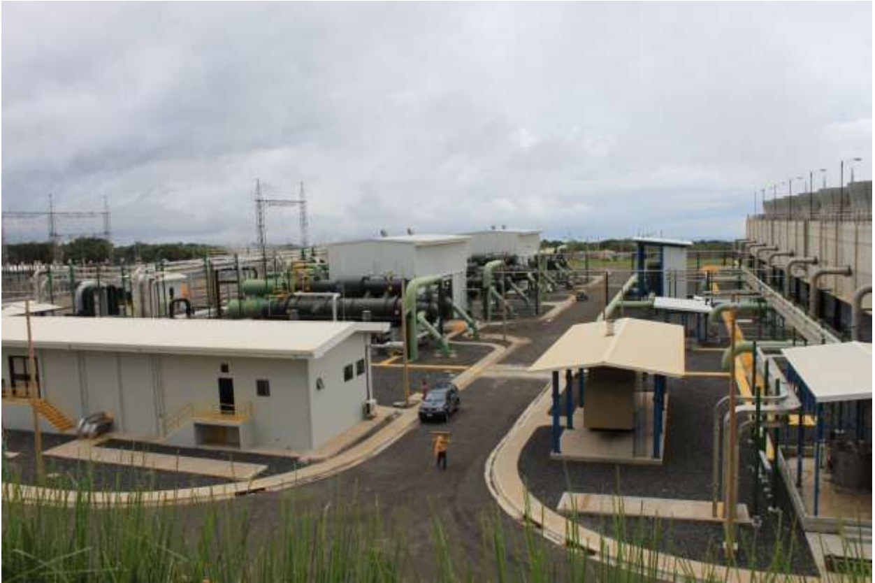
既設発電所(LasPailas I)
