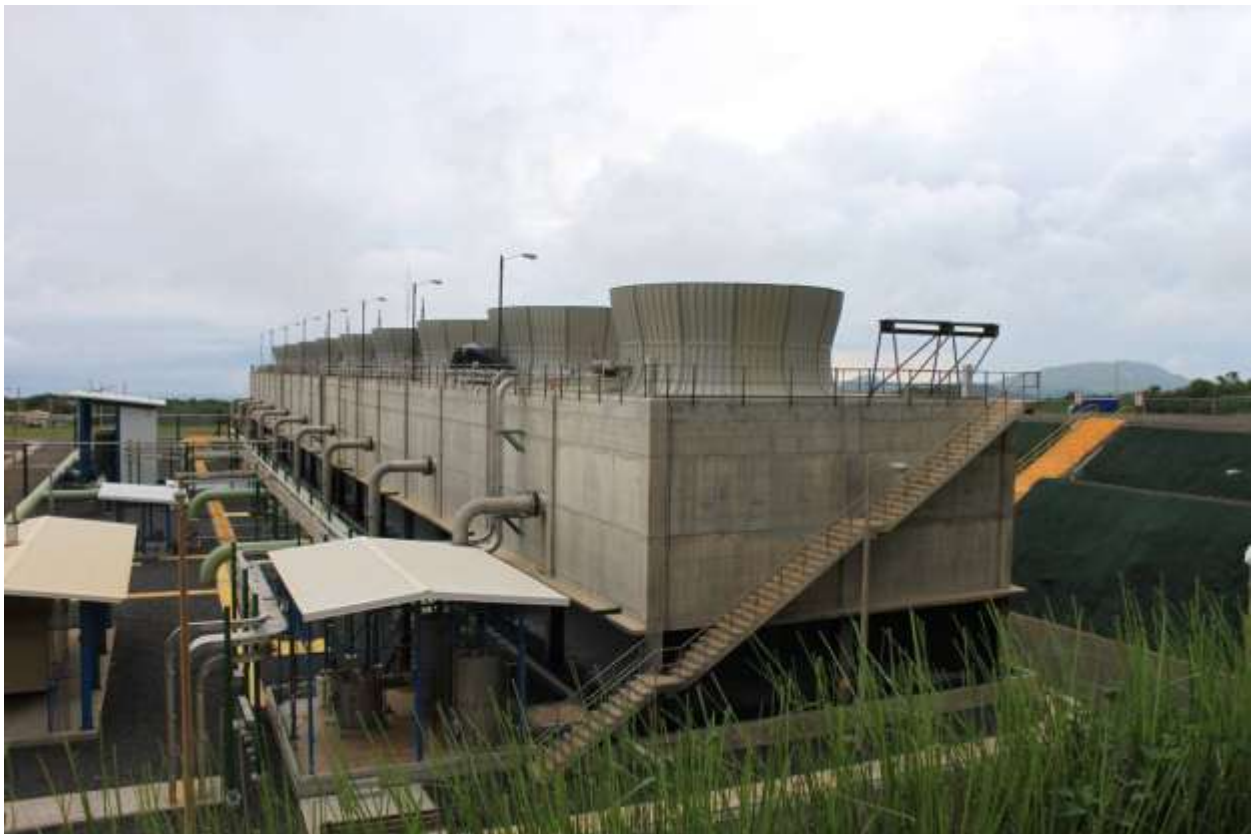
既設発電所(LasPailas I)の冷却塔
