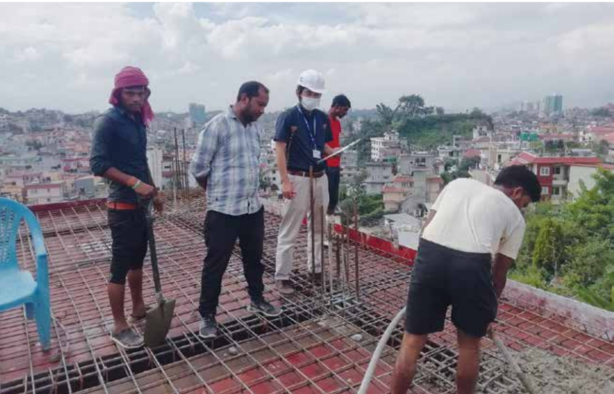
भवन निर्माण भइरहेको ठाउँमा भवन निर्माण संहिताको पालना भइरहेको छ छैन भनी गरिएको आधारभूत सर्वेक्षण
