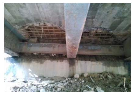
RC床版の抜け落ち (過積載者の通行が主な原因と考えられる)
