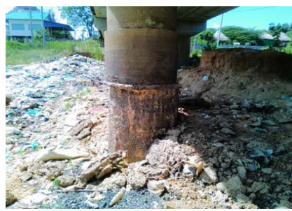
洗掘により橋脚表面のコンクリートが剥離し鉄筋が露出している
