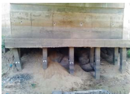
橋台の洗掘 (橋台下部の土砂が流され、全支持杭が露出している)
