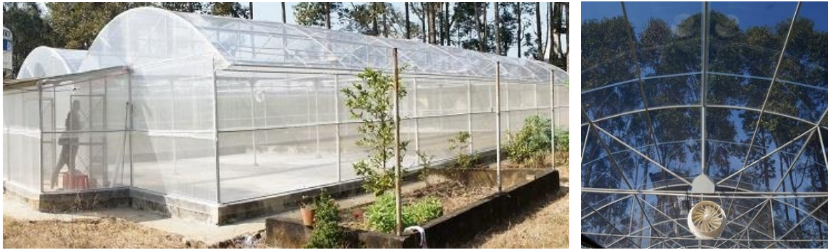
左から: 既存の骨組みの上に屋根材と網を張り替えたフンロック農業研究センターの網室、太陽光透過率 94%の屋根材はまるで屋根がないかのように透明
