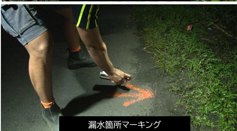
家庭用サービス管の亀裂漏水
