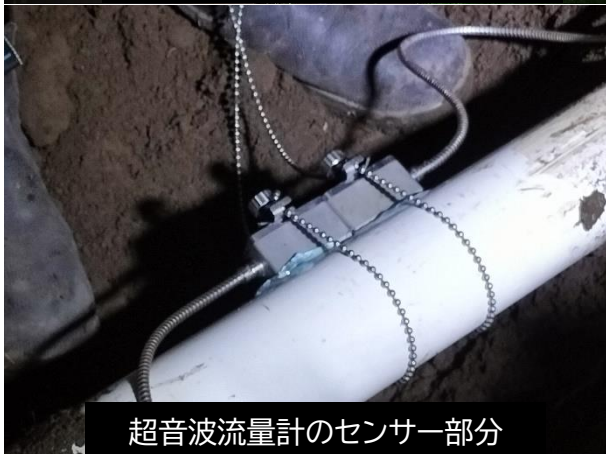
超音波流量計を使った水量計測
