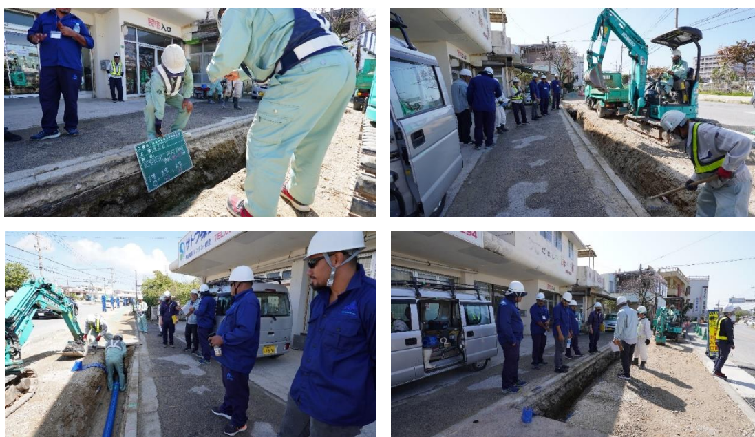
【写真キャプション】老朽ダクタイル管100mmをPE管への敷設替え工事
