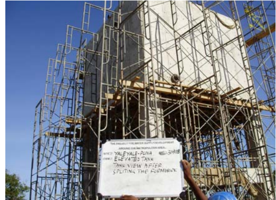
9月30日平成20年 ヤレヤレプナ(テメケ市)での施工中の写真 高架タンク(50m 3 柱高さ5m)建設現場 コンクリート打設完了後
