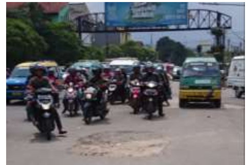
メンテナンスが行き届いていない道路
