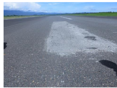
ナザブ空港の既存滑走路。舗装の痛みが激しい
