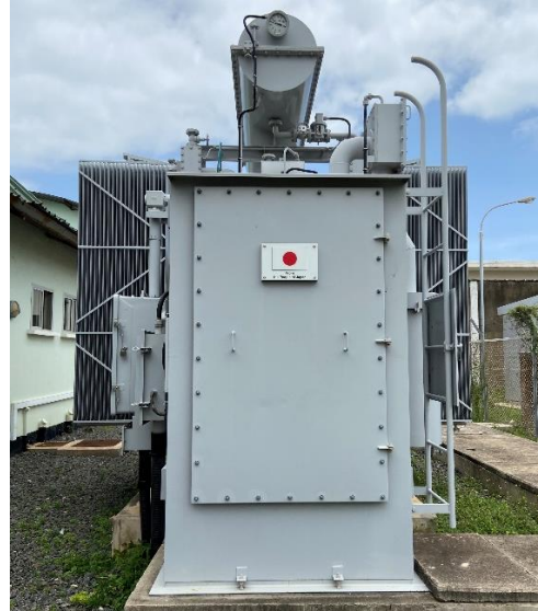
33/11kV 変圧器（ムササニ変電所）
