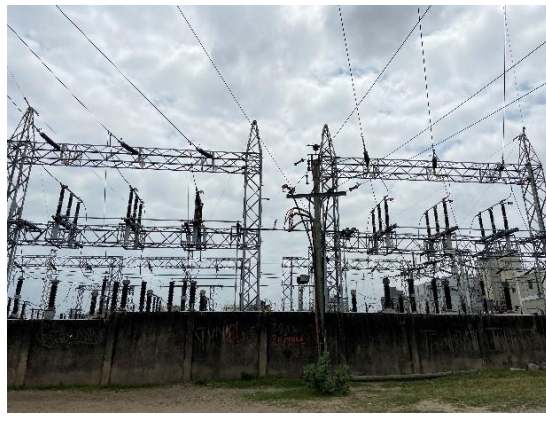
132kV 送電線ガントリー（イラ変電所）
