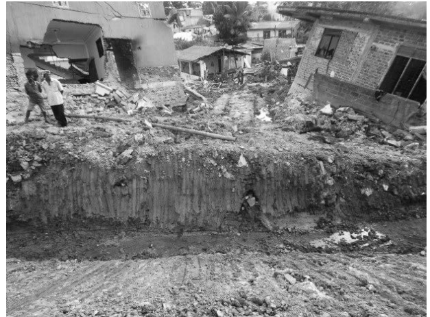
写真-4 崩壊斜面法先で見られたヒービング (2017年4月20日) [出典] 国際緊急援助隊最終報告書(2017)案
