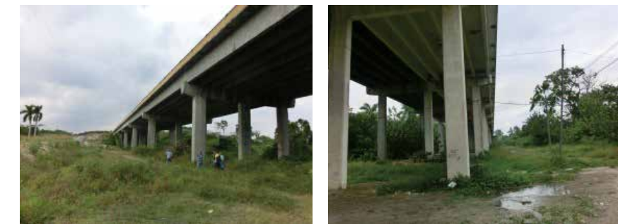
図 5.11 Via Blanca の道路橋梁の状態
