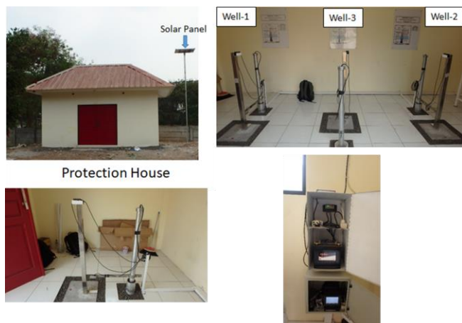
図 8 地盤沈下観測井戸
