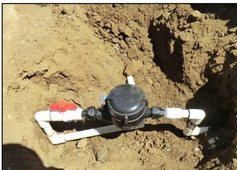
写真 2 水道メータと曲管の不適切な配置
