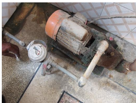
違法ポンプの状況
