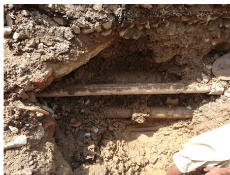
多重配管の状況
