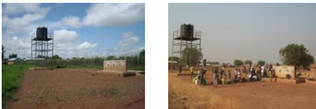
図7：高架水槽と公共水栓（写真左は雨季、右は乾季）
