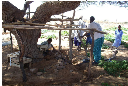
Mettre des pierres et couvrir après avoir fixé les supports en bois
