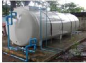
近畿地方173件 (例：滋賀県の浄化槽)
