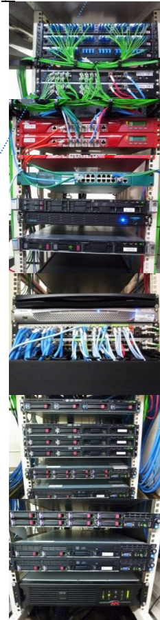
ネットワーク・サーバ系ラック
