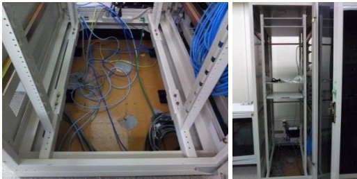
JICA-LAN機器ラック
