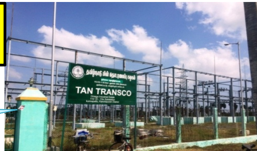
OneHub Chennai工業団地 (みずほ・日揮) : 110kV変電施設
