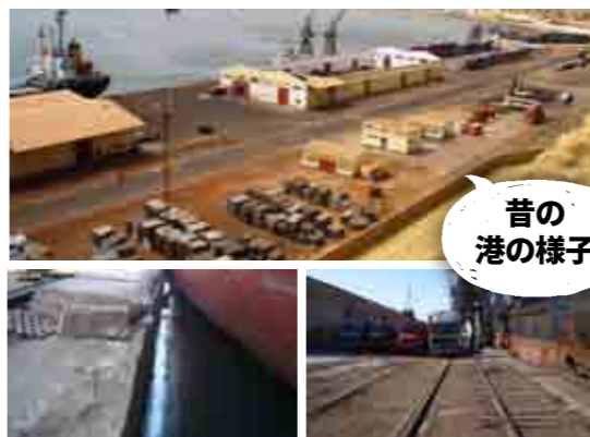
上：ナミベ港の建設は1958年。その後、約30年の内戦期間中はほとんど整備されなかった。写真は2005年の様子。下左：3B岸壁。岸壁の損傷はいたるところに見られた。下右：改修前はクレーン等の荷役機械や港内鉄道、道路などあらゆる施設の状況が劣悪だった。
