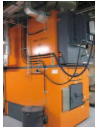
木質バイオマスボイラー
