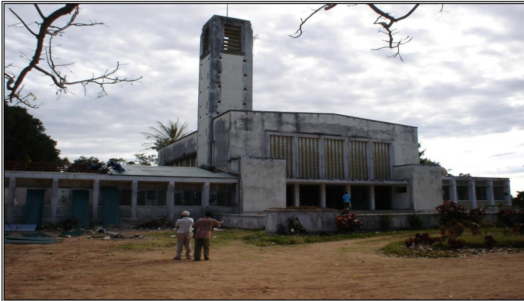
Hali halisi ya Jengo la Makao Makuu ya Halmashauri lililojengwa toka mwaka 1957 likiwa na paa la Asbestos kabla ya kukarabatiwa mwaka 2007.
