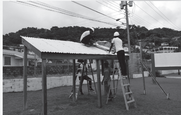
太陽光発電設備の実習の様子。再生可能エネルギーには太陽光、風力、水力、地熱、バイオマスなどがある。セントビンセントは、人口約11万人、国面積は400平方キロメートル（東京都23区総面積の約3分の2）にも満たない。発電量の一部は水力発電だが、大部分はディーゼル燃料を使用した火力発電で、交通用のガソリンなどすべての石油燃料は輸入で賄われている
