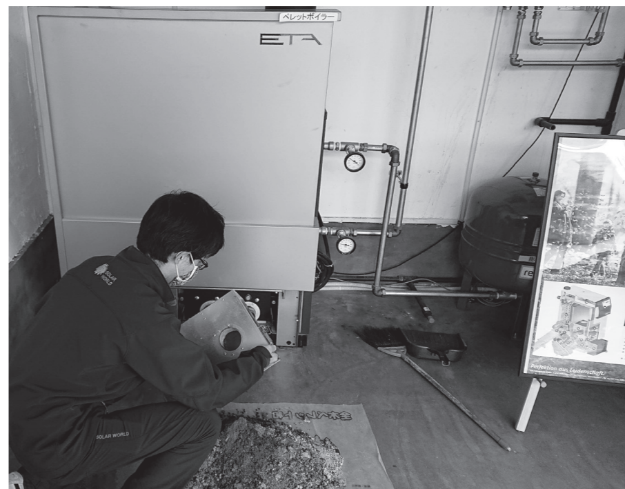
木質バイオマスボイラーの点検作業をする現在の佐藤さん。木質バイオマスボイラーで使用する燃料は、未利用の間伐材や製材工場などで残った木材、建造物を解体する際に出る木材など。同機材はオーストリア製で、輸入や設置のための調整業務を佐藤さんが担当している
