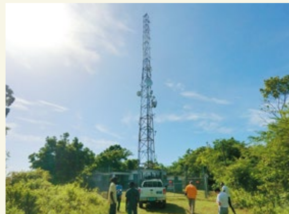
デジタル無線アンテナを設置する鉄塔。全国24カ所の鉄塔にアンテナを設置予定
