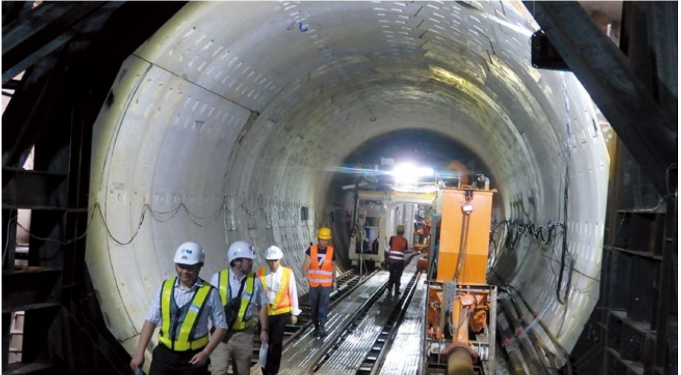
ベトナム：ホーチミン市都市鉄道1号線建設現場。シールドトンネル工法による地下トンネル工事（オペラハウス～パソン間）
