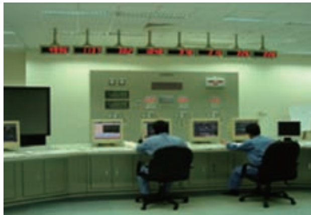
フーミー火力発電所コントロール・ルームの様子
