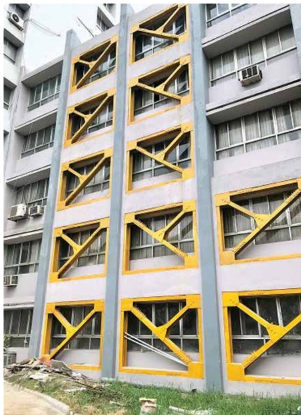
耐震強化された建物: 黄色の鉄筋がブレースと呼ばれる耐震補強材 (写真: JICA)
