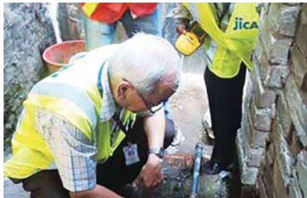
水道メーターをチェックするJICA専門家 (写真: JICA)
