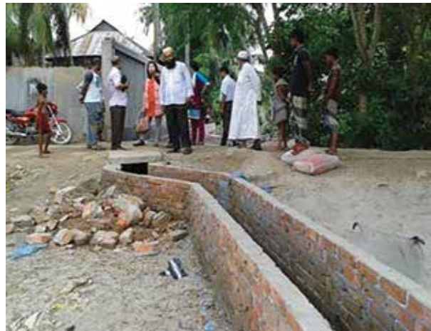
村落委員会事業によって整備された灌漑水路 (写真: JICA)
