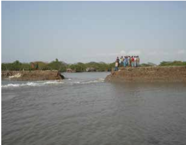
サイクロンの被害により決壊した堤防 (写真: JICA)
