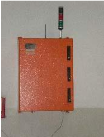
在线监测系统通信设备
