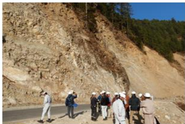
斜面災害リスク箇所が散在するブータン山岳部の道路（当機構公式ホームページより）
