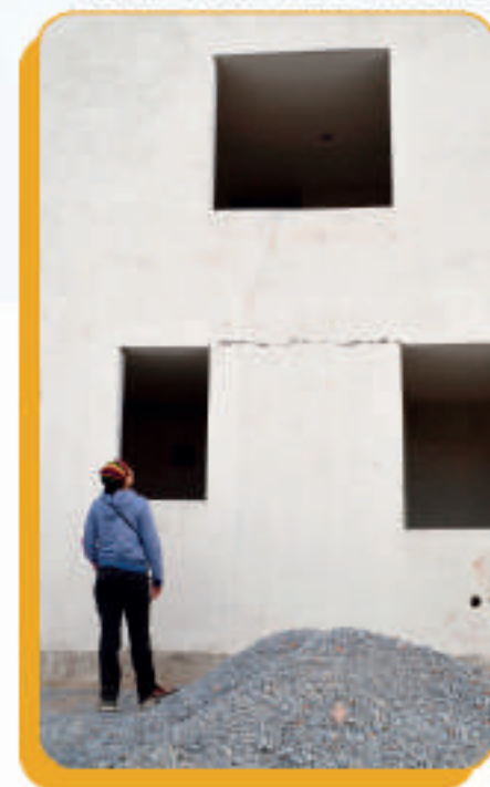
Liliana Troncoso Visita de observación a infraestructuras afectadas por el terremoto - Pujilí
