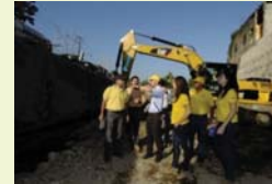
Técnicos de DACGER y especialistas de Japón que inspeccionan las obras de ampliación y protección costera de los ríos en el sitio dañado por el huracán.
