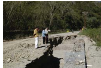
Ruta Nacional 7 con un gran daño por desmoronamiento.
