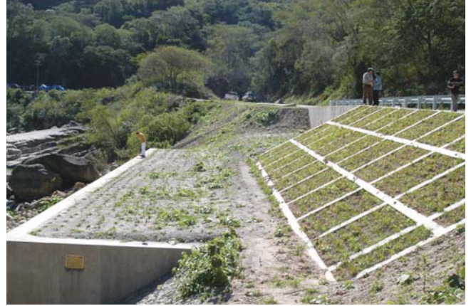
Estructura escalonada y con plantas para reforzar el arcén de la carretera (Fotografía: Fernando Xavier Cuellar Otero/JICA)
