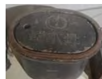
Old Meter Box
