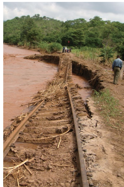
Les voies ferrées doivent être déplacées dans une zone non exposée aux risques d'érosion.
