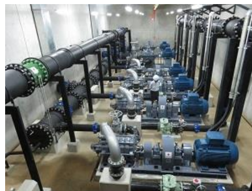
送水ポンプ室
