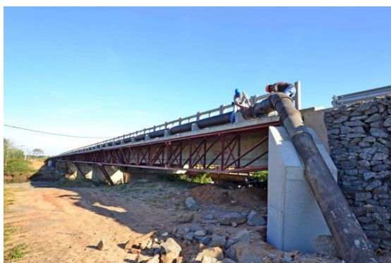
テビクアルミ浄水場からコロネル・オビエド市への送水管
