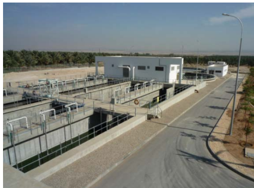
無償資金協力で建設された 下水処理場 (OD法)
