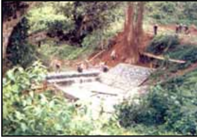
BRONJONG SEBAGAI BANGUNAN CEKDAM
