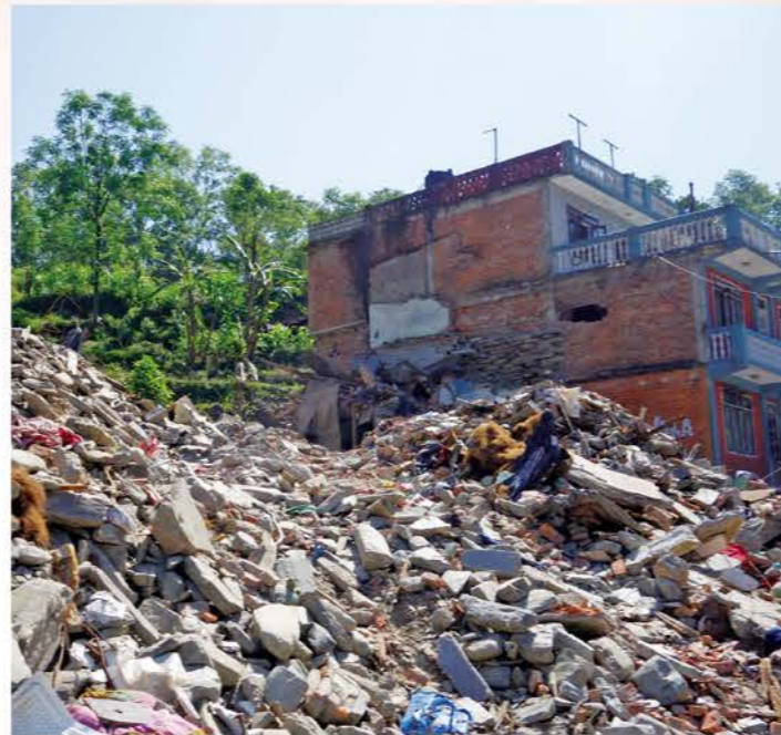
La capacidad del gobierno local en exigir viviendas resistentes resulta en la protección de los ciudadanos. El edificio que resistió al derrumbe gracias a las varillas de acero y las vigas, aunque sean insuficientes (parte fondo de la imagen) y el edificio popular derrumbado (parte frente). (Nepal, mayo de 2015)
