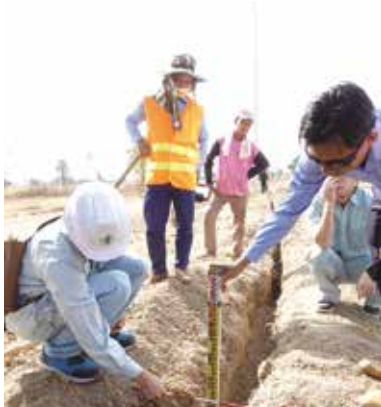
上水道管路の維持管理能力向上支援（ラオス）
