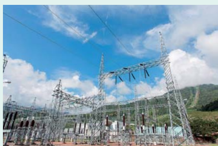
現在のダム水力発電所（JICA 事後評価報告書）
