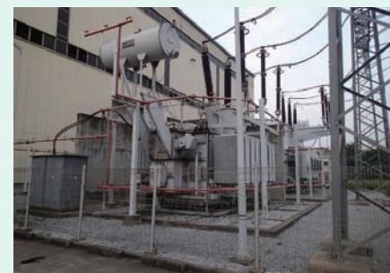
Trạm biến áp
