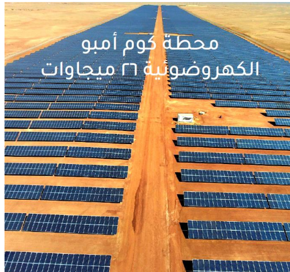
kom ombo PV 26 MW
