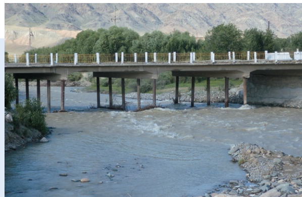
老朽化した架け替え前のウルマラル川橋梁
