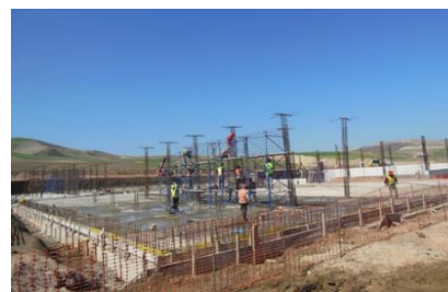
モロッコ「フェズ・メクネス地域上水道整備事業」浄水場建設工事
