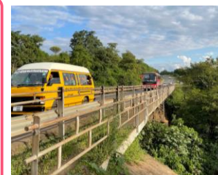
事故が多発している橋
