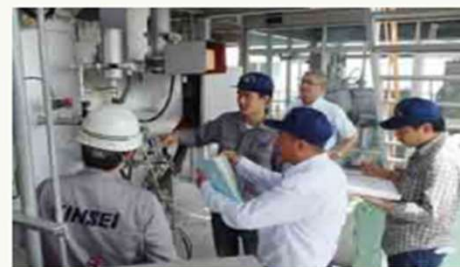
上:同社ではチェンマイ大学からのインターン学生を受け入れたり、現地パートナー会社の研修生を受け入れたりと同社を理解する人が増えたことも成果のひとつ / 下:タイで設置工事を行っているのと同型の乾溜ガス化燃焼装置
