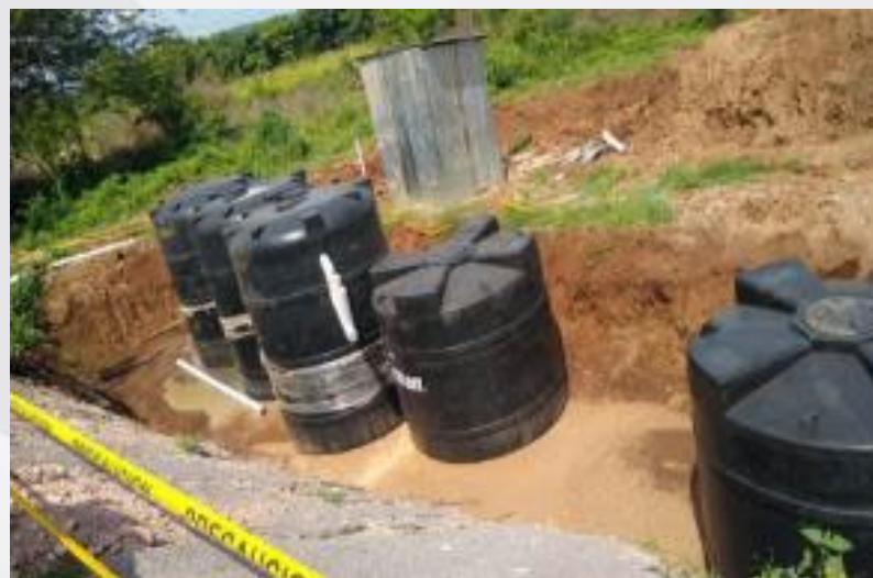
廃水処理中の様子
