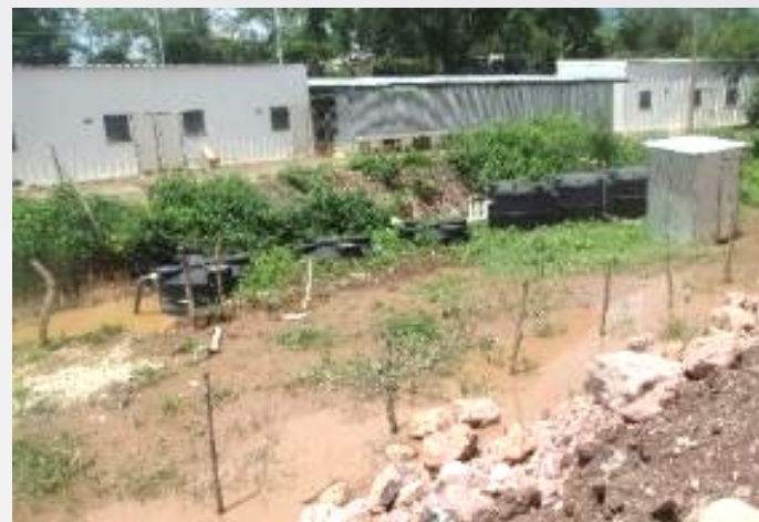
廃水処理システム
